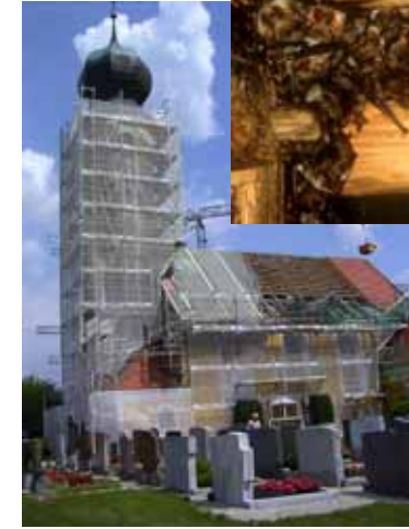
Dachstuhl bewohnende Fledermäuse wie das Große Mausohr sind bei Sanierungen gefährdet.
